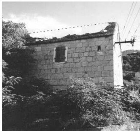
Slika 8: Derutni gospodarski objekt sa urušenim krovom i srušenom unutrašnjom konstrukcijom Dilapidated out-building with collapsed roof and demolished internal structure.
